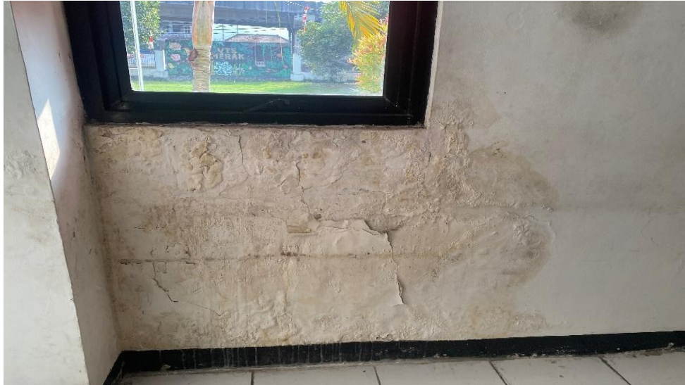
Gambar 2. Kondisi Salah Satu Dinding Pada Ruang Tunggu Pelayanan PNBP Kantor Vessel Traffic Service Merak
